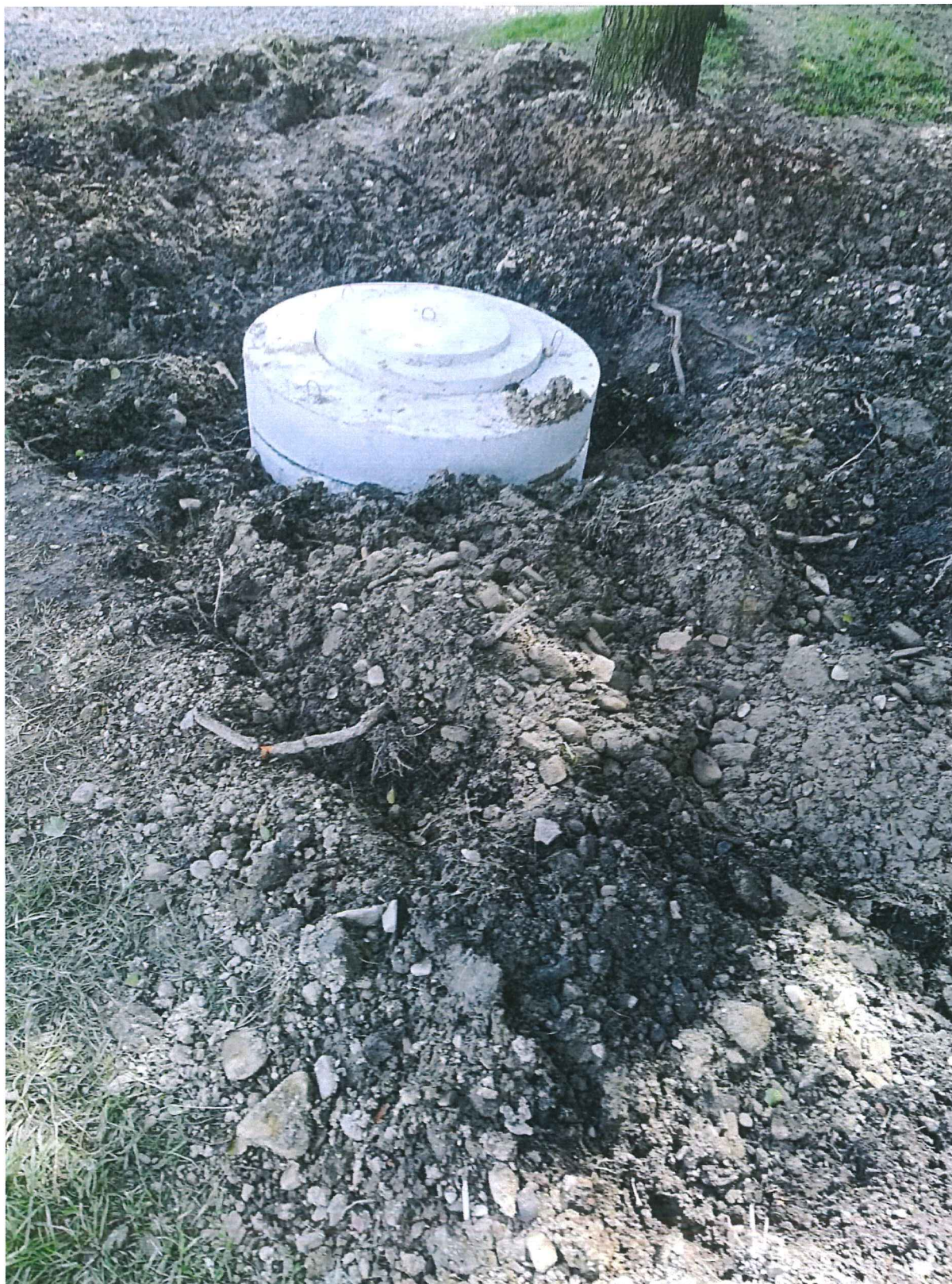
Awaryjny remont kanalizacji deszczowej w rejonie Szkoły Podstawowej nr 8 na Górnym Borze w Skoczowie
