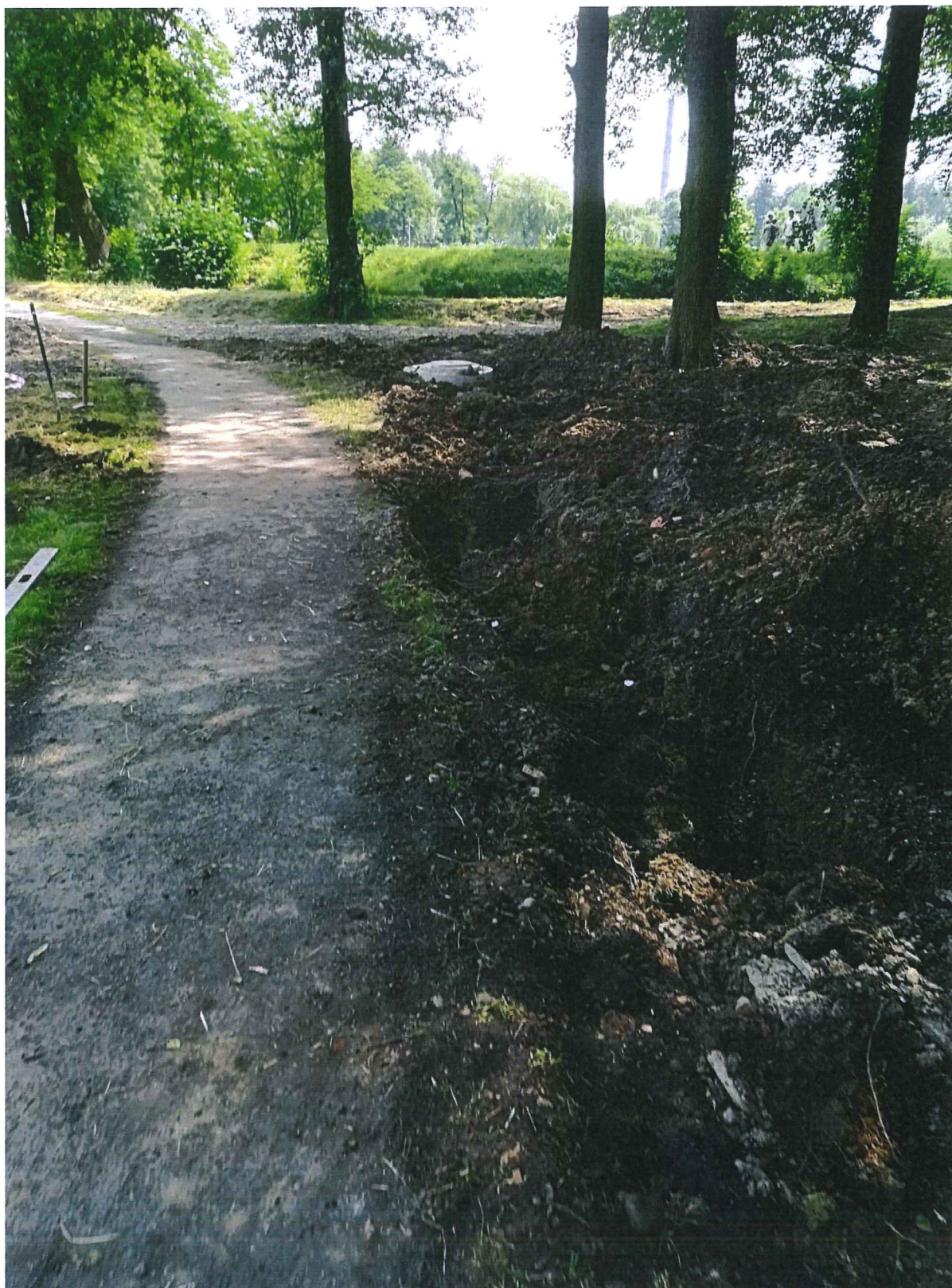
Awaryjny remont kanalizacji deszczowej w rejonie Szkoły Podstawowej nr 8 na Górnym Borze w Skoczowie
