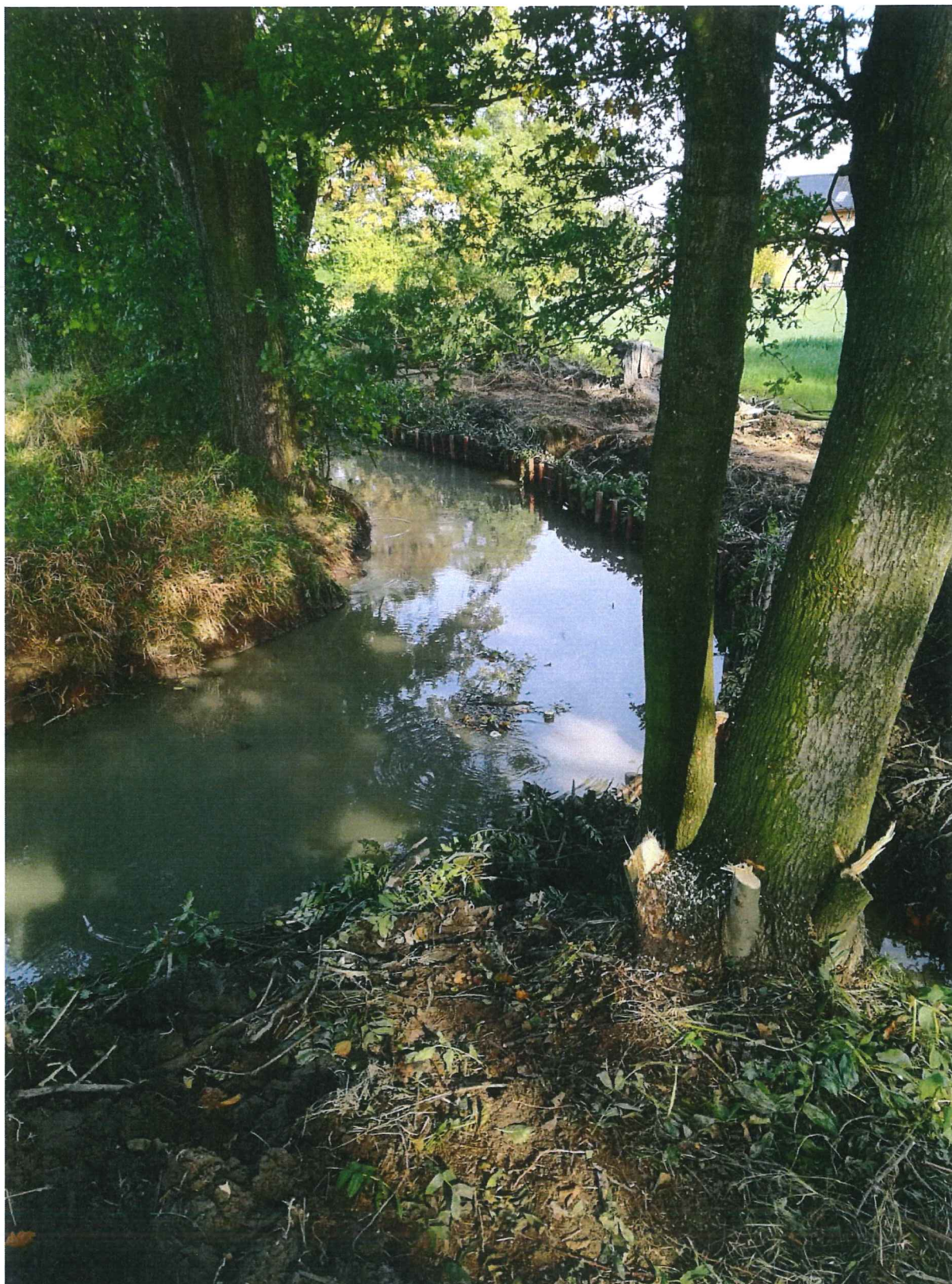
Wykonanie awaryjnego udrożnienia koryta cieku Lewobrzeżnej Młynówki Kiczycyckiej w Ochabach Wielkich w rejonie ul. Cesarskiej
