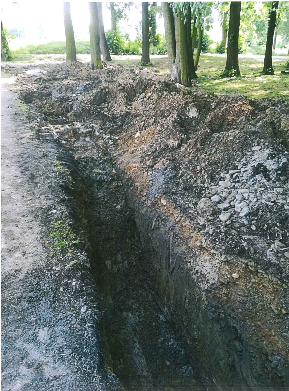
Awaryjny remont kanalizacji deszczowej w rejonie Szkoły Podstawowej nr 8 na Górnym Borze w Skoczowie
