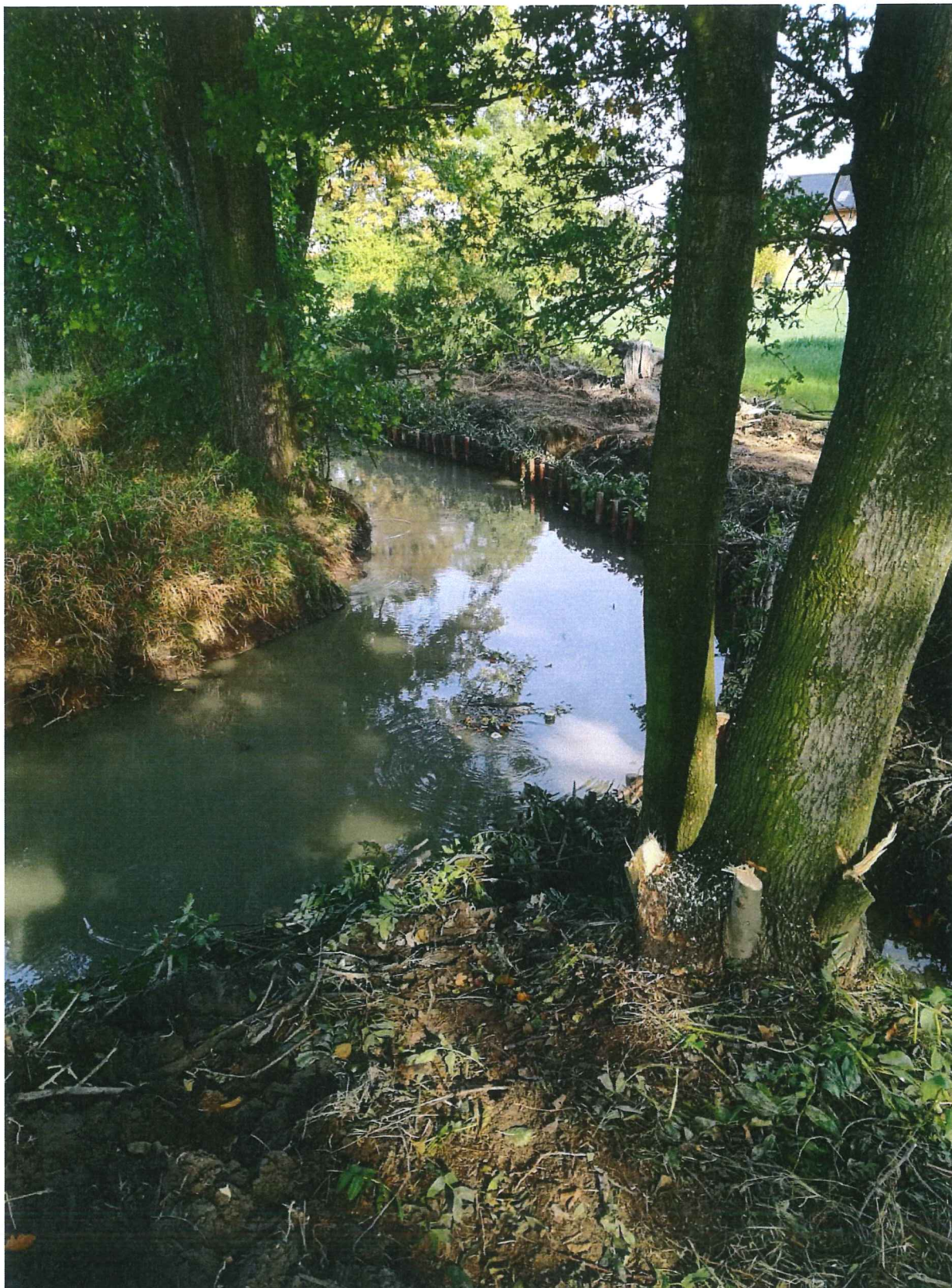
Wykonanie awaryjnego udrożnienia koryta cieku Lewobrzeżnej Młynówki Kiczyczej w Ochabach Wielkich w rejonie ul. Cesarskiej
